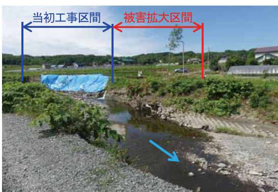
写真-2 工事着手前に被害拡大(内未成)
