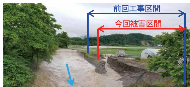
写真-1 かごマット(多段)の被災状況(未満災)
